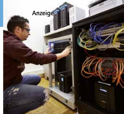
Herr Habermeier bei der Erweiterung eines Speichersystems
